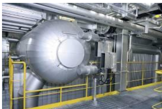
【蒸気ボイラー】
