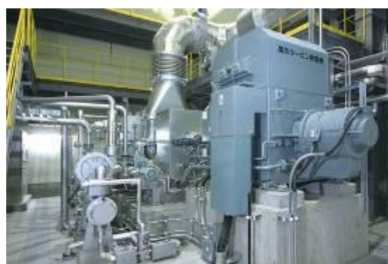
【蒸気タービン発電機】
